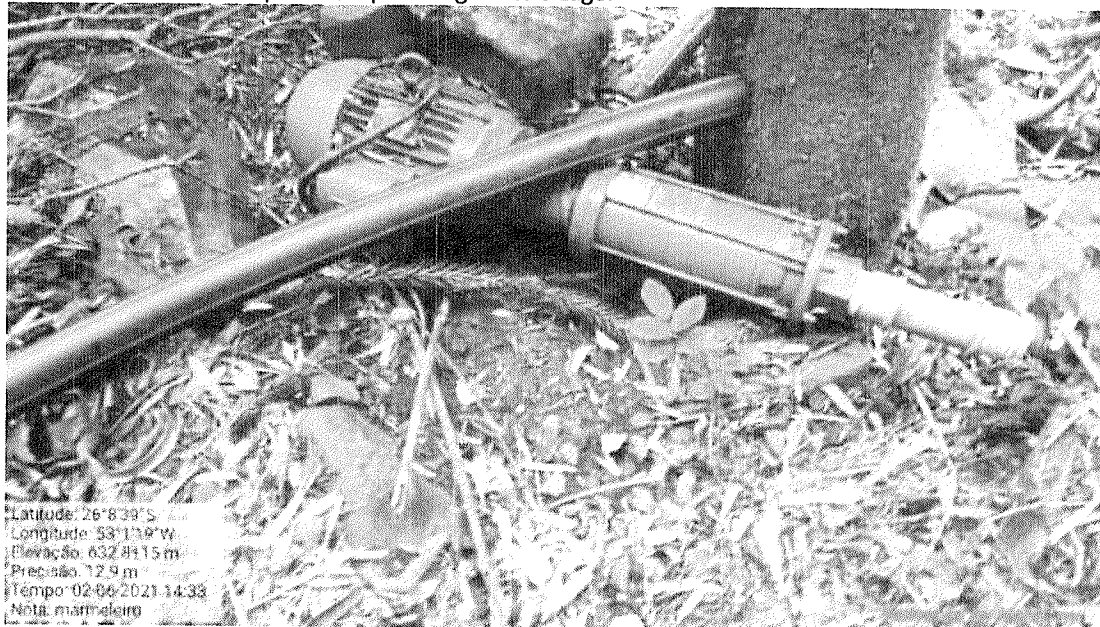
Foto 1: Bomba utilizada para transportar água até o Lago.
